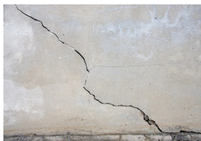
Verputzte Wand mit Rissen
