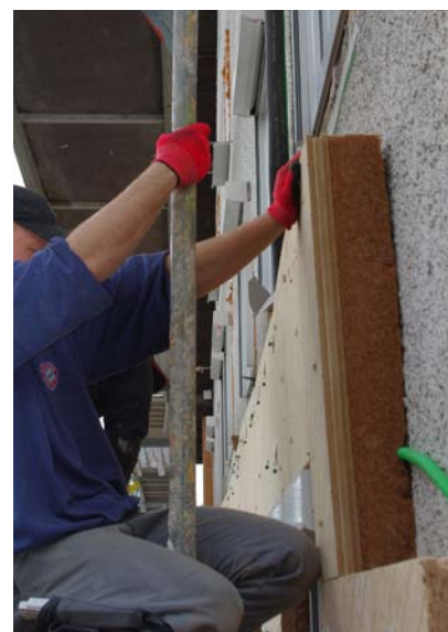
Kabelschläuche sicher verbergen
